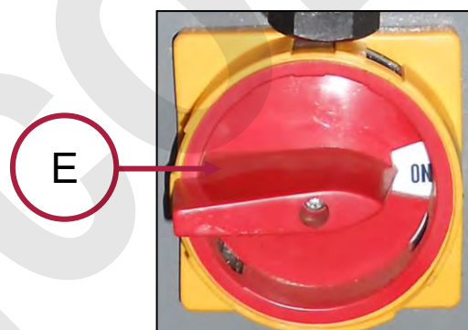
Figura 9 – Quadro di comando.
